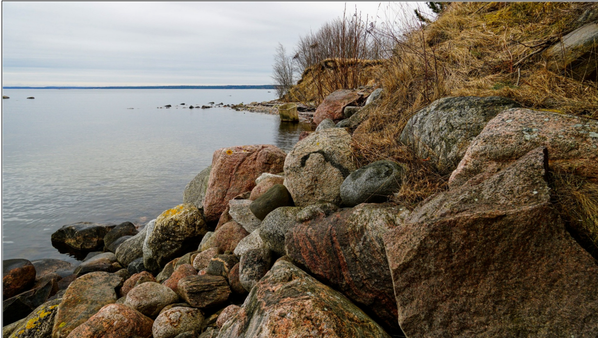
08: Fotel 07 paikneva nõlva jalami piirkond. Jalam puudub.
